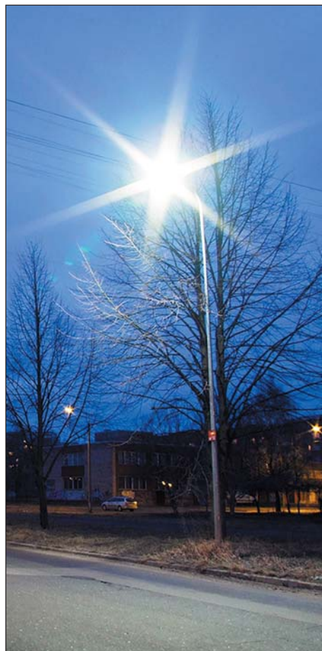
Рис. 8. Фонарный столб, оборудованный светодиодным светильником для уличного освещения KL STREET 96 (Рига, ул. Келдыша)
