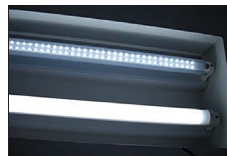
Рис. 4. Замена ЛЛ на светодиодные типа Т8
