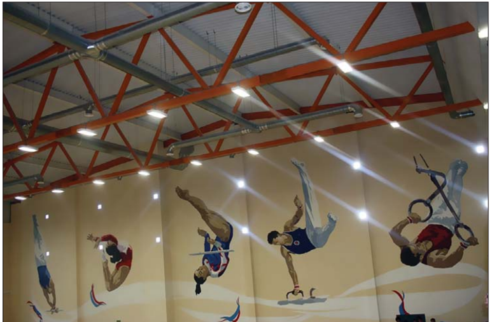
Рис. 2. Светодиодное освещение Детско-юношеской школы олимпийского резерва № 3 Калининского района Санкт-Петербурга (центральный гимнастический зал). Светильники ТИС-17 и ТИС-17-2
