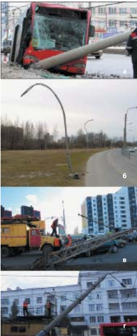
Рис. 2. Примеры повреждений опор освещения
