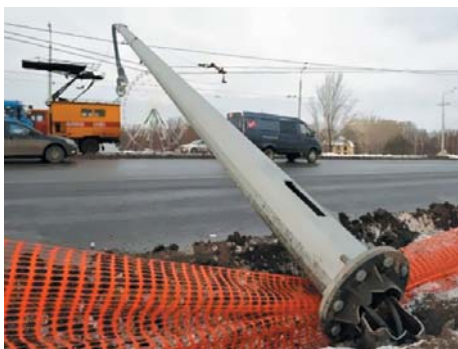
Рис. 6. Падение опоры НО на троллейбусные провода в дневное время
