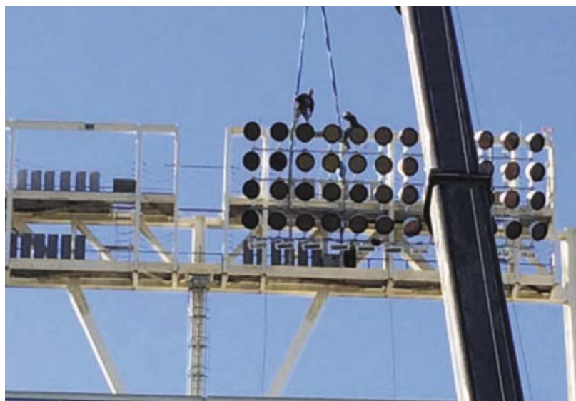
Рис. 4. Компания Musco работала с «Сан-Диего Падрес», монтируя новые светодиодные осветительные стойки на земле, а затем поднимая готовые стойки на верхнюю часть стадиона «Петко-парк»
